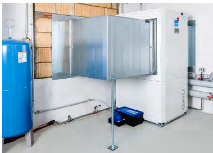
Wärmepumpe mit Luftkanal und Kondensatbox.
