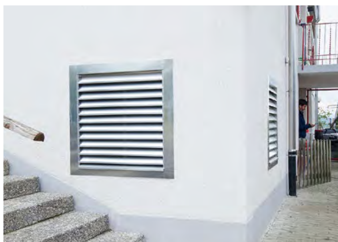
Aussenansicht von Luftein- und -ausblas übers Eck.
